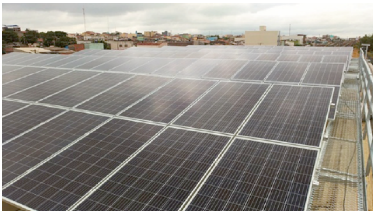
Imagem aérea das placas fotovoltaicas implantadas na sede da Restauranteiro Distribuidora de Alimentos.
